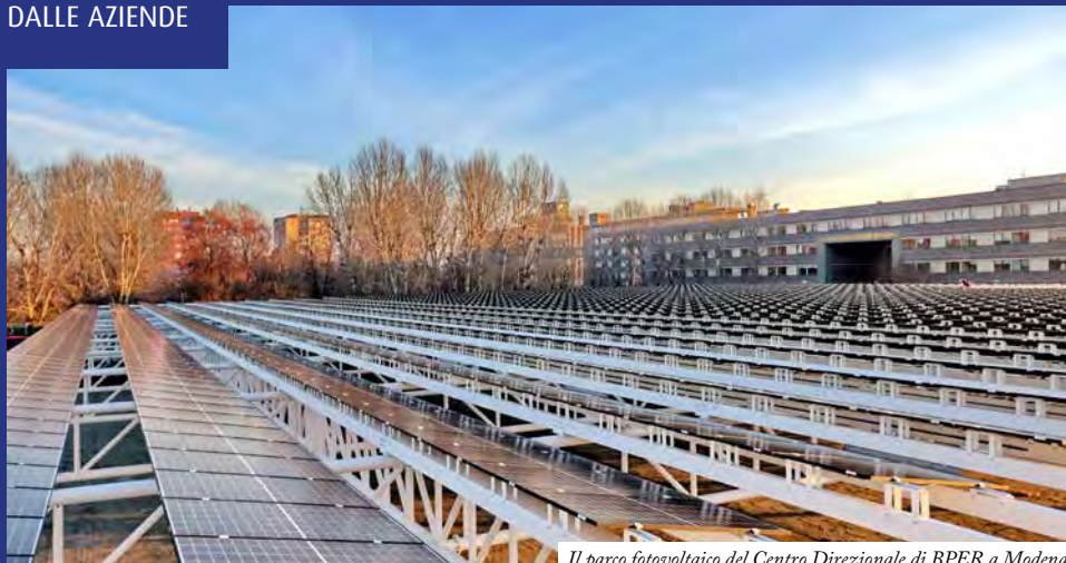
Il parco fotovoltaico del Centro Direzionale di BPER a Modena
