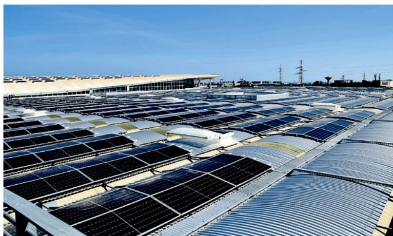
▲ I pannelli L'impianto fotovoltaico sul tetto dello stabilimento Masmec
